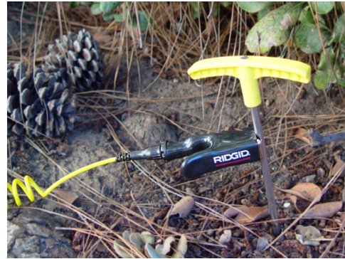
Рисунок 6 – Зажим подводящего провода, подсоединенный к заземляющему стержню
